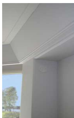
Diskret installations- kanal, vän 1
